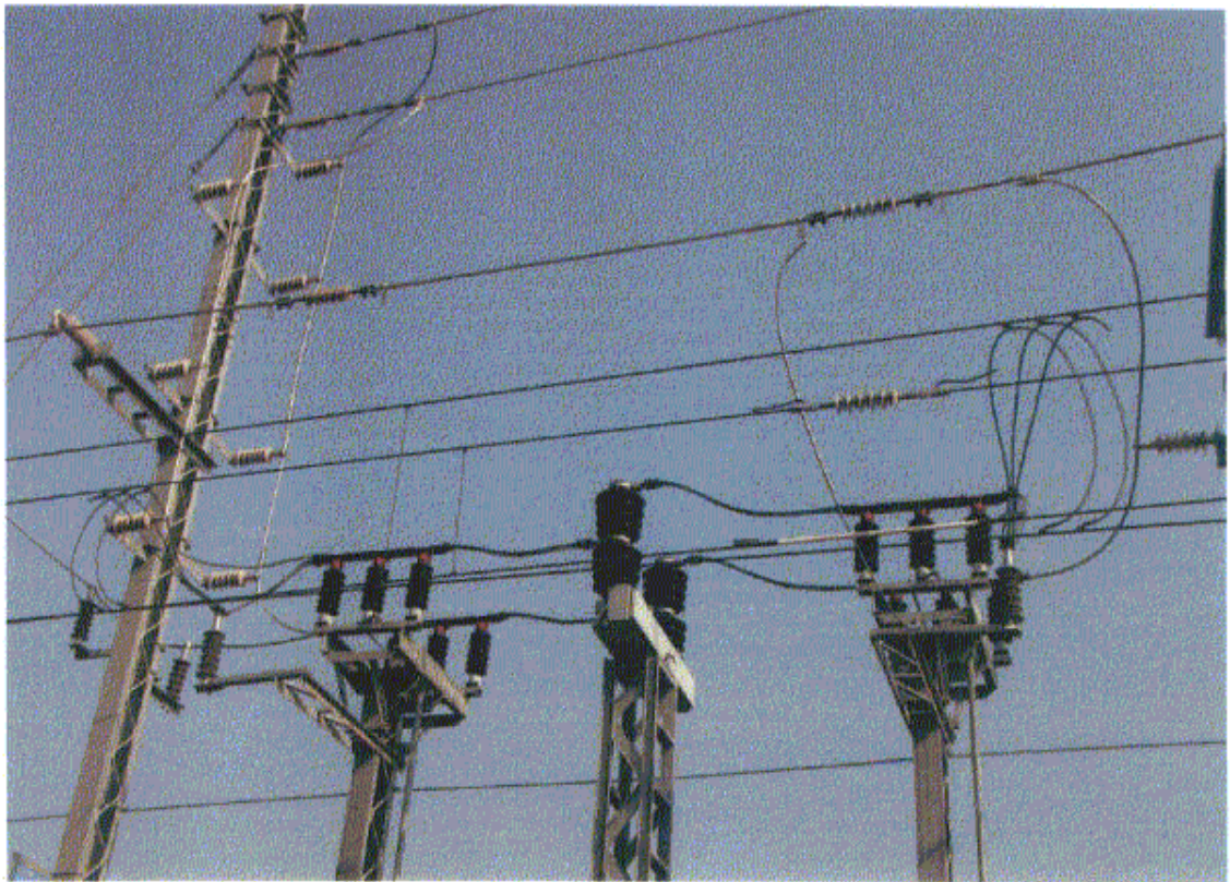
Fig. 2 – Sezionatori ed interruttori di linea
